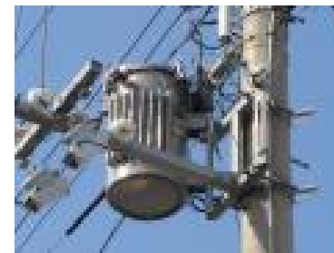
電柱の上にある柱上トランス： 高圧の送電線(6600V)から 100V/200Vの家庭用に
