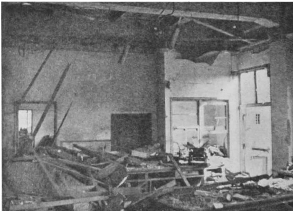
写真 20 長崎。爆心から 800m の、コンクリート造の病院の部屋。建物は構造的に損傷を受けておらず、内部火災による被害を免れた数少ない建物の 1 つ。つり天井、パーティションなどの崩壊により、多くの犠牲者が出た。火災が起きていれば、ひどい状態になっていただろう。
