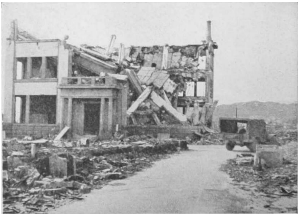
写真 8 広島。右側の爆心から 200m の鉄筋コンクリート建築物。爆弾の爆風で屋根スラブが押し下げられ、スラブが柱頭の周りを剪断し、内部の柱の残骸を突き抜けた状態となっている。
