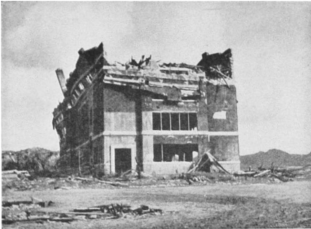
写真 5 長崎。写真右の爆心から 500m 鉄筋コンクリートの木造屋根の学校。爆心から遠い側の長い壁の上部は、部分的にはもう一方の長い壁からの屋根を経由したスラストにより、部分的には吸い込み風により折れ曲がった。これはマスディストーションの典型例である。
