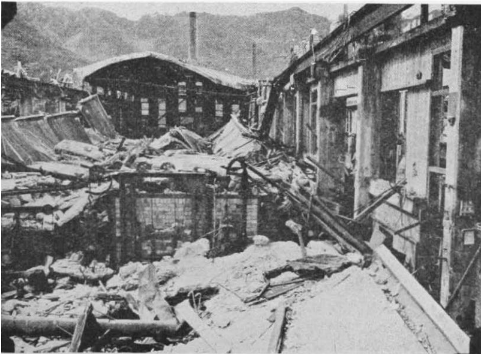
写真 10 長崎。右側の爆心から 1.6km 圏内の鉄筋コンクリート 1 階建て工場。アーチ型の鉄筋コンクリート屋根が損傷し、爆発に近い側が内側に、遠い側が上方に押し上げられた。
